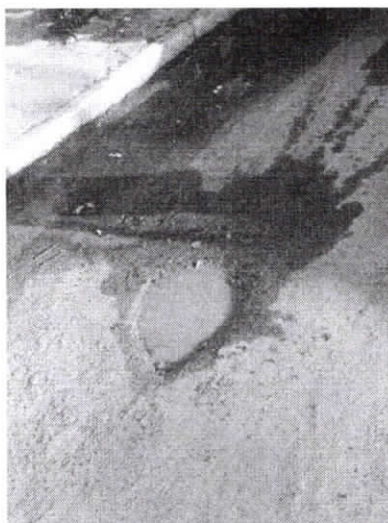
Foto do vazamento
