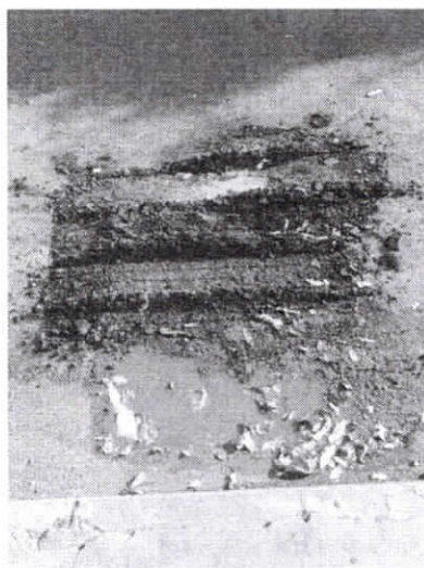
Foto do vazamento
