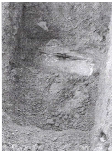
Foto do motivo do vazamento
