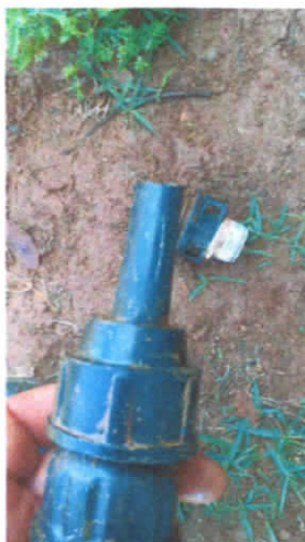
Foto do motivo do vazamento
