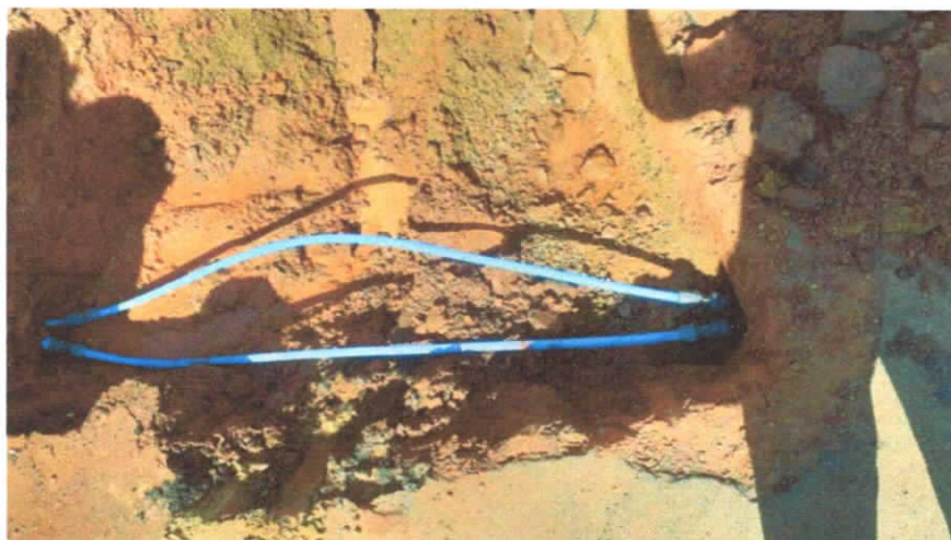
Foto do vazamento executado
