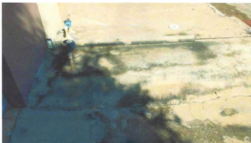
Foto do vazamento executado
