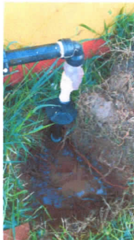
Foto do vazamento executado
