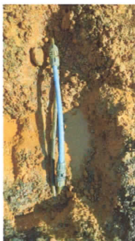
Foto do motivo do vazamento
