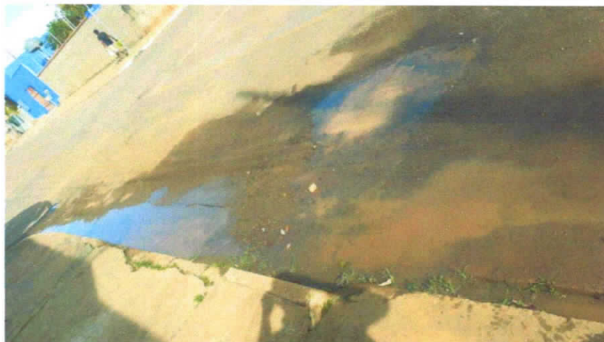
Foto do vazamento
