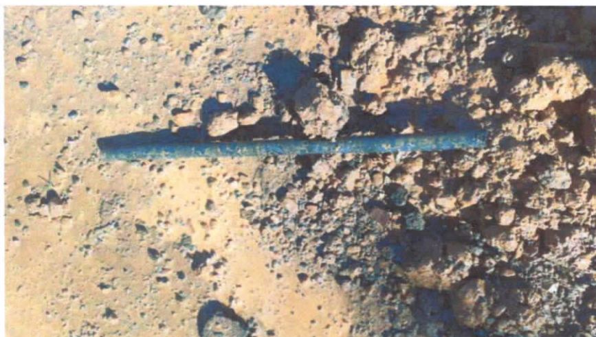
Foto do vazamento executado
