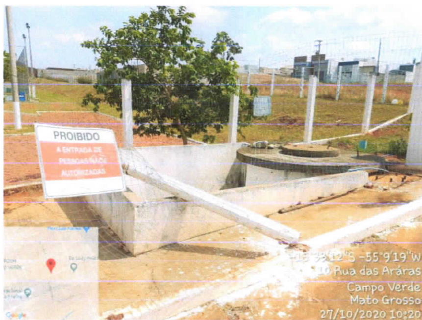
Imagem: Detalhe do alambrado danificado.
