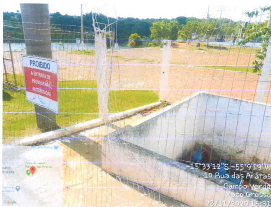
Imagem: Detalhe do alambrado danificado.
