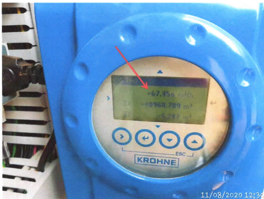
Imagem 01: Destaque da vazão instantânea em m³/h no poço 13.
