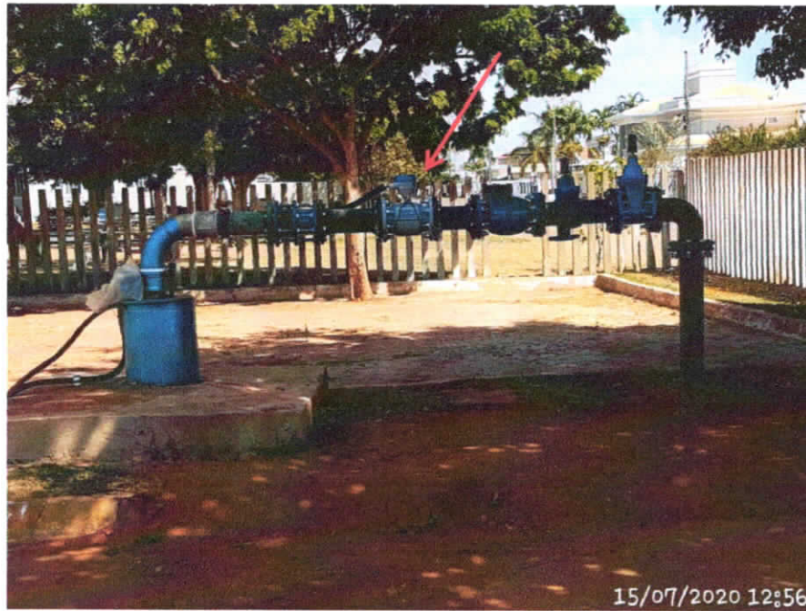
Imagem 01: Detalhe do macromedidor no barrilete do poço 13.
